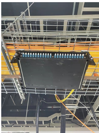
网络桥架下安装
